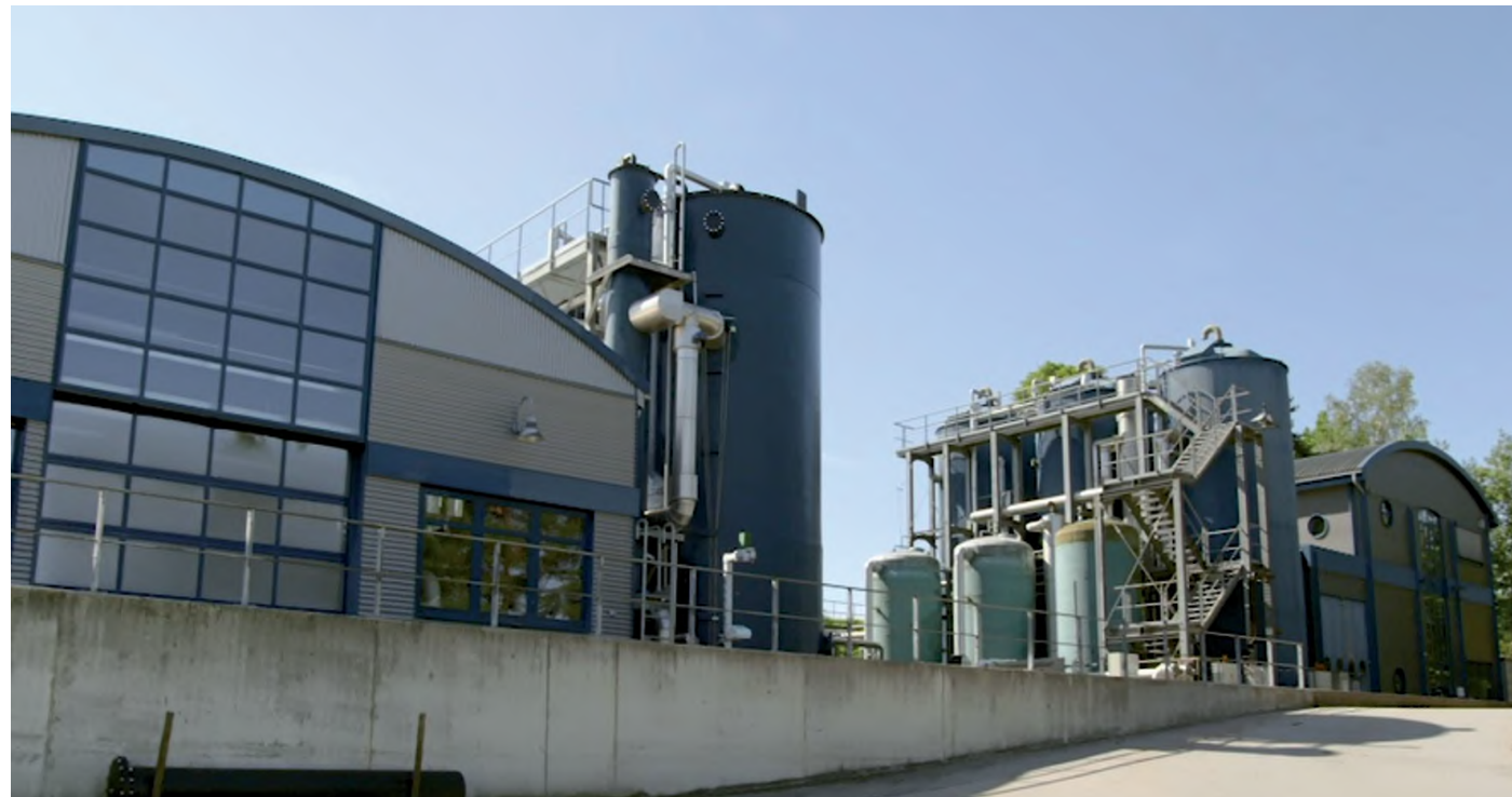
Die Sickerwasserbehandlungsanlage auf der Deponie Mathiasgrube: hier werden noch anfallende Sickerwässer in einer biologischen, chemischen und physikalischen Behandlungsstufe gereinigt. Die Anlage besteht im Wesentlichen aus den Komponenten Behälterbiologie, Ultrafiltration und Adsorption.
